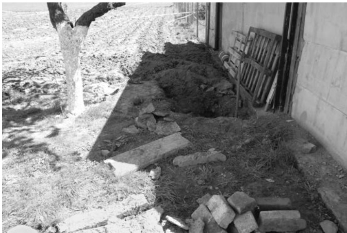
Fot. 1. Widok ogólny miejsca ujawnienia szczątków po częściowym usunięciu gruzu (dokumentacja fotograficzna pochodzi z akt sprawy)
